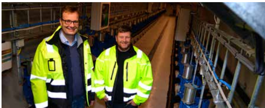
Ventiltanken – 45 m lang - med sine 42 ventiler på hver side – totalt 84 Foto: Kjell M. Jacobsen
