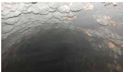
Rustknoller: Etter at kummene var satt ned, kunne ledningen renses for rustknoller med spesialutviklet skrapeutstyr. Foto Kjeldaas AS
