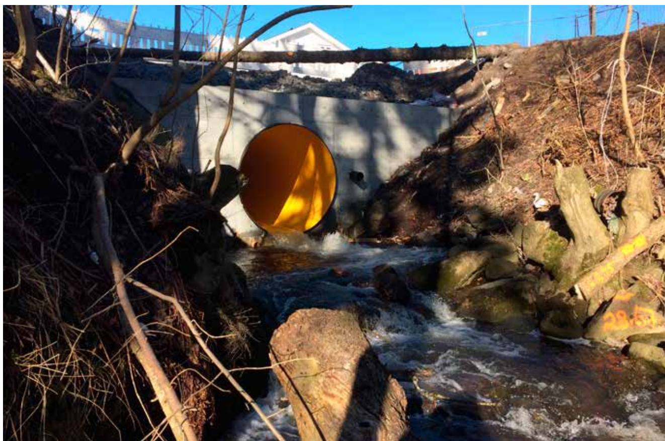
«Den eksisterende kulvert ble erstattet med et nytt, dobbeltvegget PE-rør og dimensjonen ble utvidet til Ø2200 mm.»
