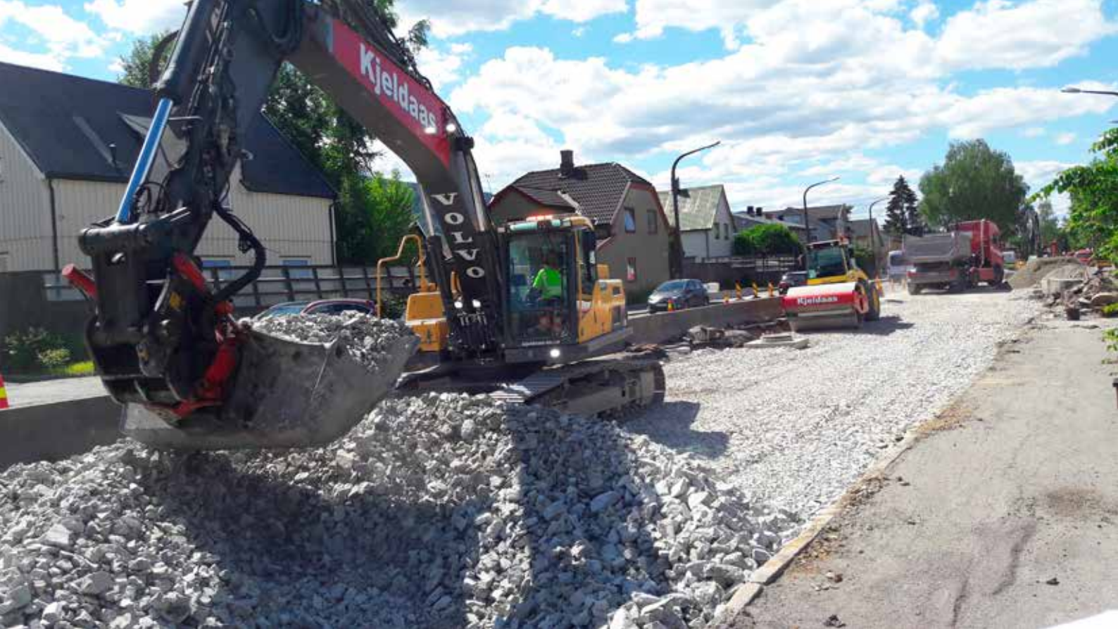
Veioverbygging: Stedsvis utskifting av forsterkningslag i begge kjørefeltene i begge kjøreretninger uten stans i trafikken krevde god planlegging. Foto Kjeldaa AS
