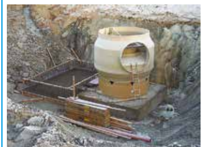
Virveloverløpet FluidSep og kloakkpumpestasjon i ett – driftserfaringer fra 1995
