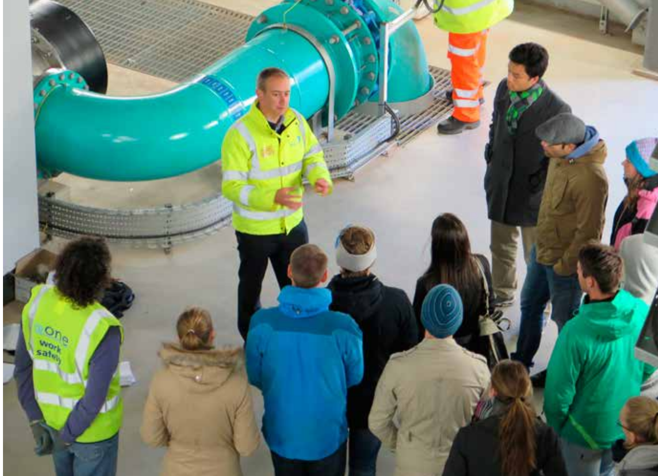
Ved anlegget ble hvert steg forklart nøye. Her foran et av rørene som leder inn til UV-behandlingsanlegget. Foto: Anders Budde Erichsen
