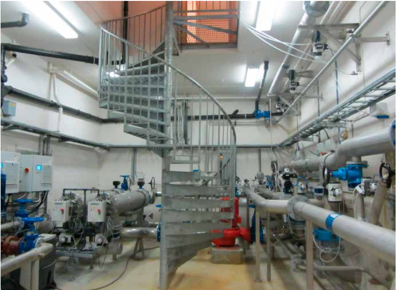
Maskinrommet på vannverket
