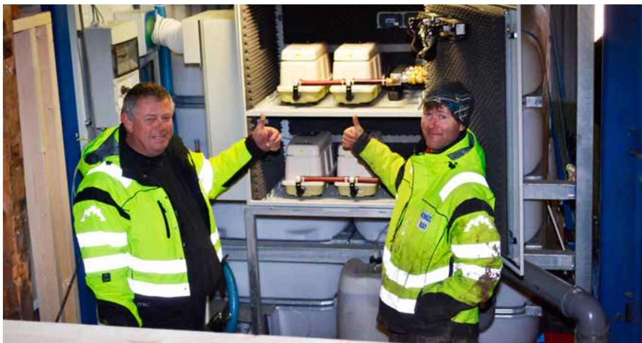
Klar for nye utfordringer er nordmøringene fra venstre: Driftsleder Hallgeir Reitan og rørlegger og «primus motor» i det praktiske arbeidet av anlegget – rørlegger Eivind Aasen.
