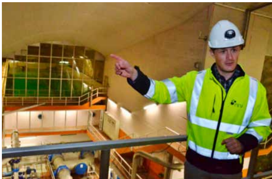
Vannverket i Haugliffell produserer i snitt ca. 500 l/s, men har i dag produksjonskapasitet på ca 950 l/s. Her er det foretatt store investeringer med bygging av UV, et nytt rentvannsmagasin på 18.000 kubikk og dublering av linjene, forklarer driftssjef Markus Rawcliffe. Foto: Odd Borgstrand
