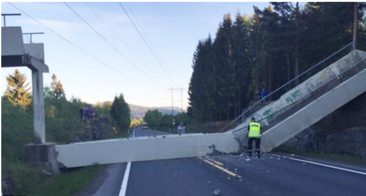
Bilde: Gangbru raser på riksveg 35 ved Vikersund nord
